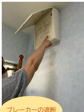
ブレーカーの遮断
