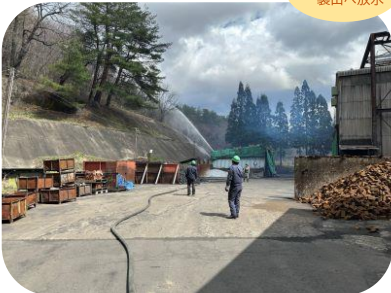
強風時 裏山へ放水
